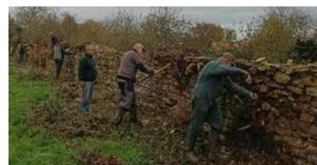
Une vingtaine de personnes ont travaillé toute la journée pour préparer le mur avant sa reconstruction.
